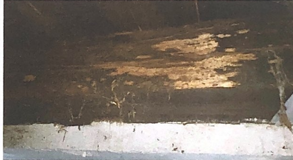
Detalhe da ação dos cupins sobre linhas de apoio assoalho. Completamente comprometida essa linha.
