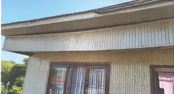
Detalhe do abaulamento forro sacada
