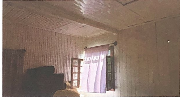
Detalhe abaulamento forro interno
