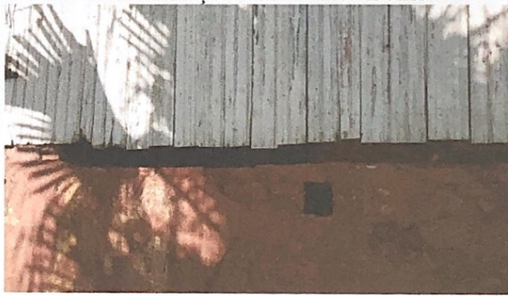
Detalhe da deterioração fechamento externo
